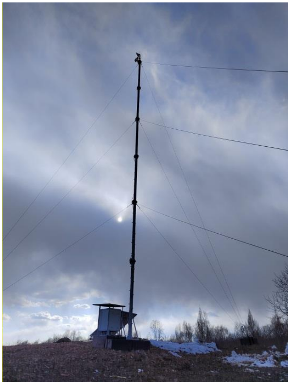
Рис. 9. Антенно-мачтовое сооружение с питанием от солнечной электростанции и системой видеонаблюдения
